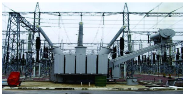
Fig. 1 – Reator em derivação a núcleo ferromagnético isolado a óleo (Website Energoato RAESA).
