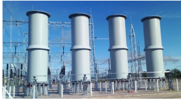
Fig. 4 – Banco de Reatores monofásicos de barras de 230kV a núcleo de ar da Subestação Jaurú 500/230kV (da esquerda para direita são mostradas as fases Azul, Branca, Vermelha e Reserva, respectivamente).
